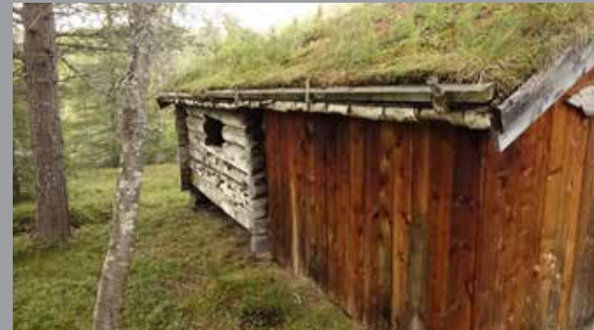
Dette panelet har fått en tjærebehandling, men kunne med fordel stått ubehandlet.
