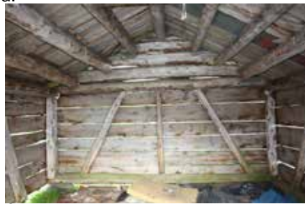
Skjelterkonstruksjonen er en materialbesparende byggemetode og er mye brukt i både fjøs, løer og andre mindre bygninger. Her er det brukt liggende panel, men som oftest er det brukt stående panel. (Se s. 32)
