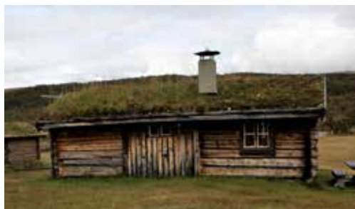
I denne seterstua på Enlivollen i Endalen er det satt inn ei pusset elementpipe.
