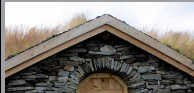
Noen steder, som her på steinfjøset på Evensmovangen, er vindskiene kryss-lagt i mønet. Dette er en nyere måte å utføre vindskier på. Fortsetter neste side
