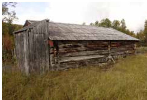
Bølgeblikkplater har reddet mange hus fra forfall når de gamle torvtakene ble lekk.
