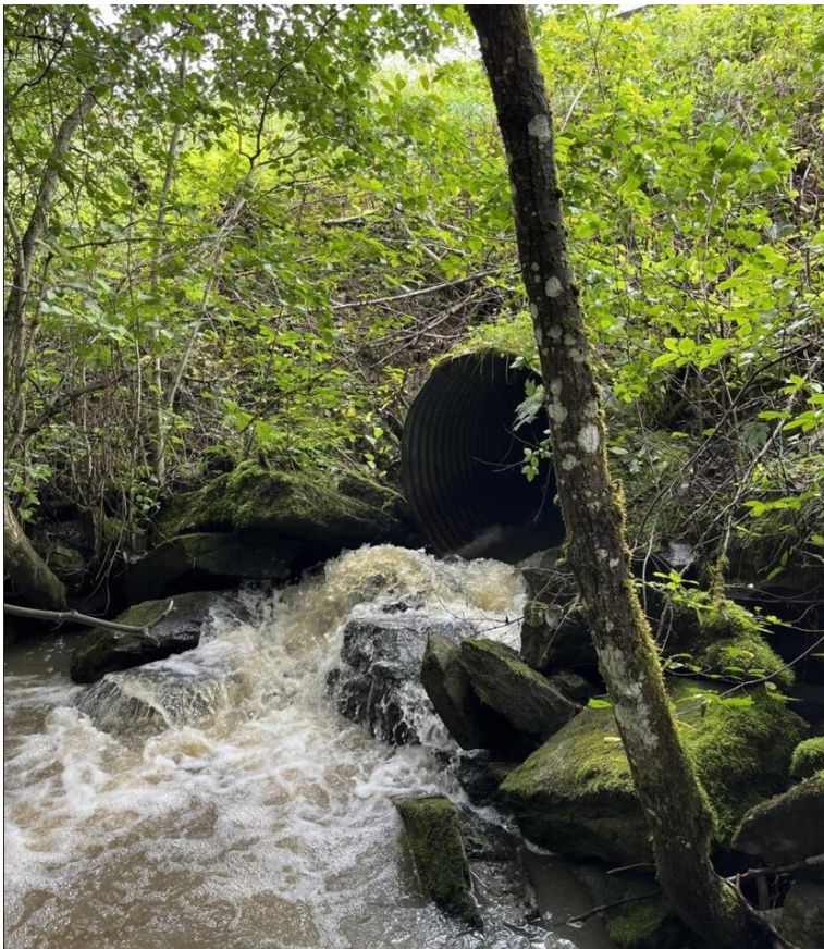
Figur 4: Utløp av kulvert K1 som går under kommunal vei. Store steiner ved utløp som erosjonssikring og energidreper.
