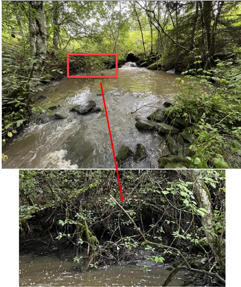
Figur 5: Utløp av kulvert under kommunal vei, K1, med nedstrøms kunstig terskel. Erosjon ble observert på nordsiden av utløpet i foten av veifyllingen.
