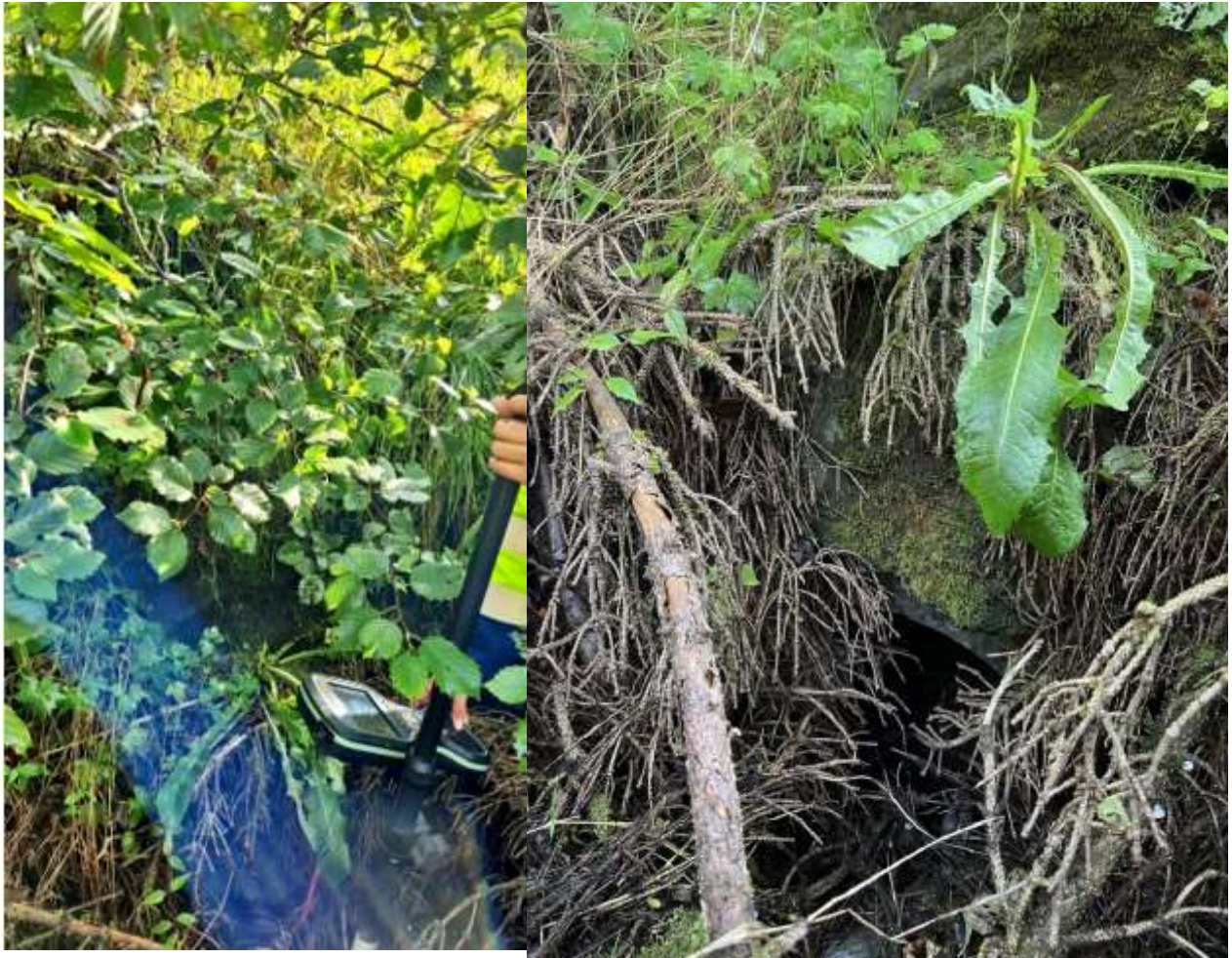
Innløpet er nesten tett. Fikk ikke målt dimensjon. Tiltak må gjøres. Gammel steinmur over kulvertåpning.
