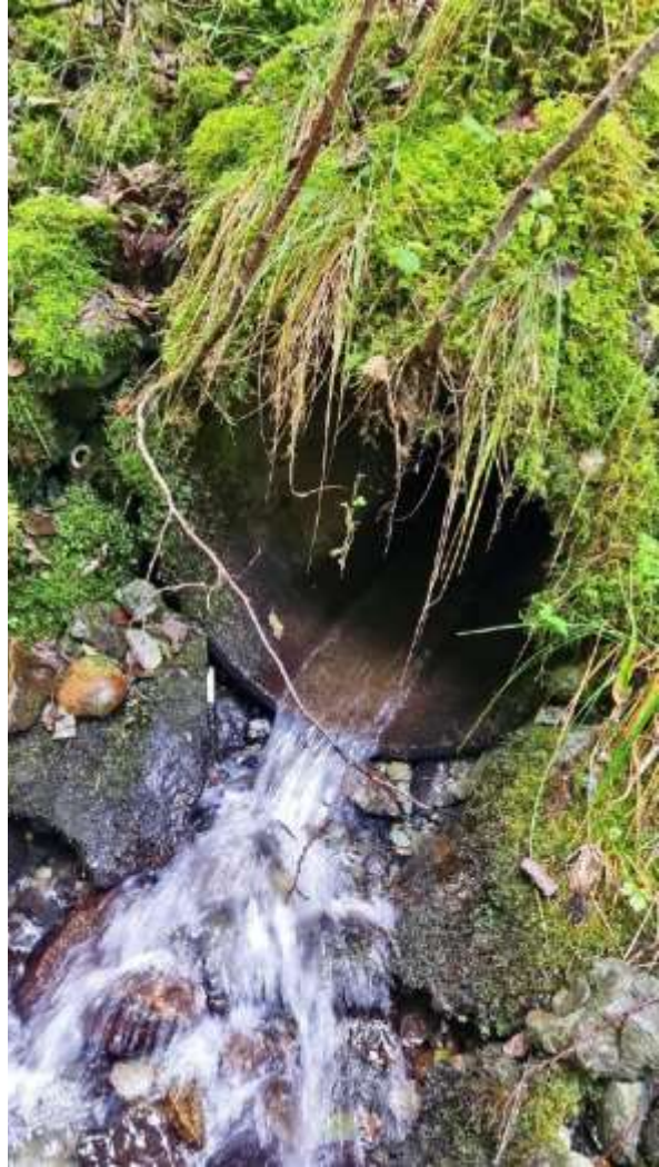
Utløp: Diameter innvendig rør: 600 mm. Betong Veldig bratt skråning ned mor utløp.
