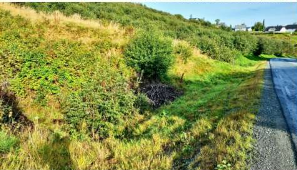
Erosjon i skråning mellom vei og bekk
