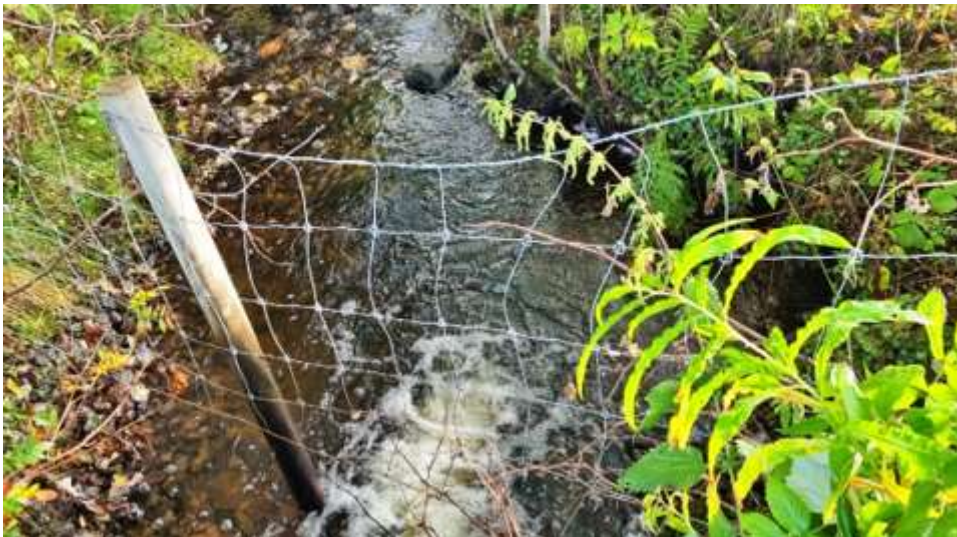
Errosjon i utløp. Stor fart ut av kuvert.
