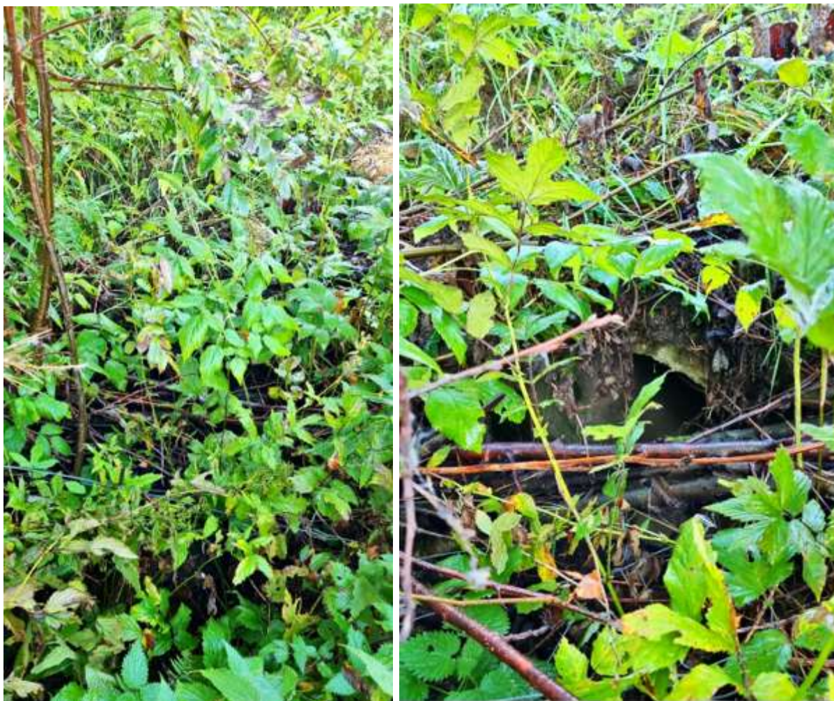
Utløp. Innvendig Diameter 60 cm
