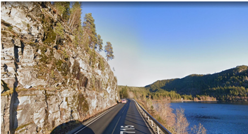
Figur 11: Dagens situasjon med høy bergskjæring og smal grøft samt grov steinfylling i strandsonen.
