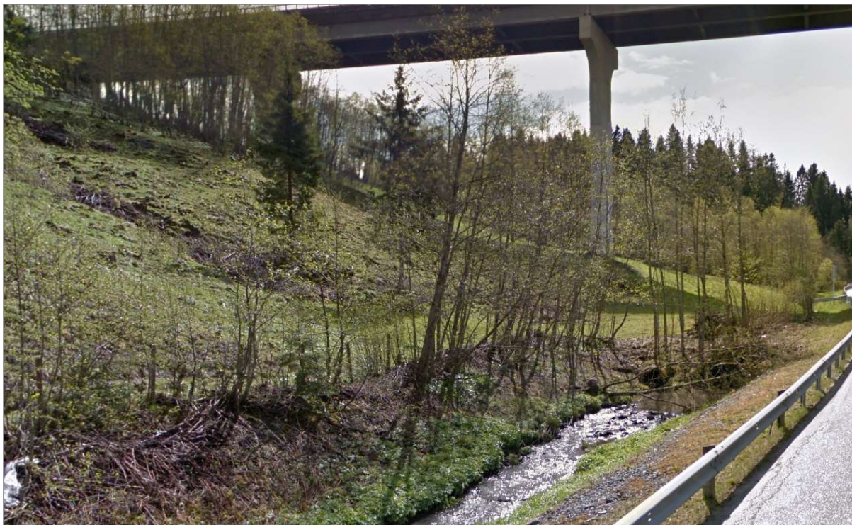
Figur 3-7. Kulverten som går under Bjørndalsbrua er et vandringshinder for fisk, og vurdert som absolutt anadrom grense i Heimdalsbekken i dag (pers.medd. M. A. Bergan). Kilde: Google Streetview.
